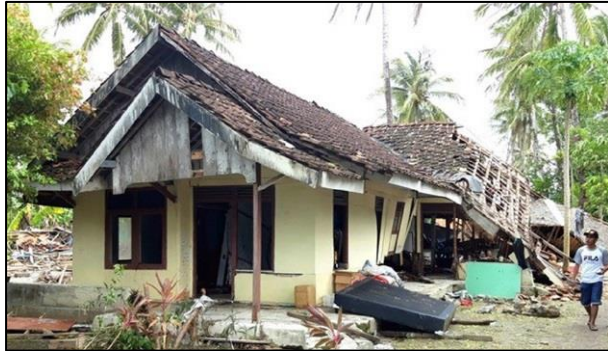
Gambar 2. Bangunan yang terdampak tsunami tahun 2018 di Kecamatan Rajabasa (Syamsidik dkk., 2020)
